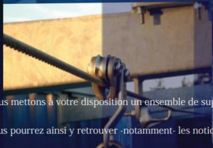
LIGNE DE VIE OVER HEAD
